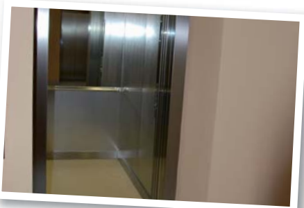
Jeden z výťahov po rekonštrukcii. Všetky tri výťahy sú vybavené hlasovou službou, displejom, ovládacie panely vo výťahoch sú označené Brailovým písmom a výťahy disponujú sklopným sedadlom pre handicapovaných.
